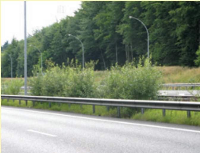
Saules marsault s'étant installés par succession naturelle dans la bande centrale et pouvant exercer un effet anti-éblouissant.
