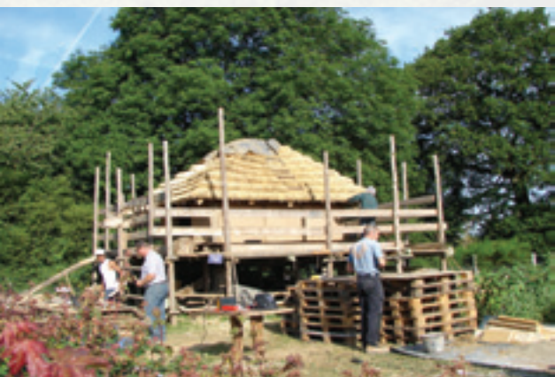
Exemple positif: La construction des abris pourrait faire l'objet d'une exécution artisanale et manuelle par les équipes d'organisations sociales.
