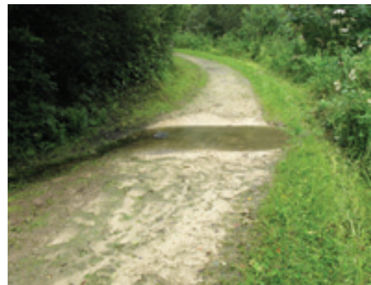
Exemple positif: Chemin mixte pour piétons et cyclistes en concassé à Pétange. L'eau passe par-dessus la surface de circulation par un gué. Dans ce genre de projets, il importe de veiller à la sécurité des usagers (signalisation).
