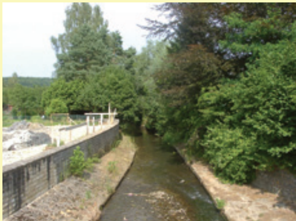
Situation initiale avant nouvelle construction et installation des pieux de fondation (après destruction de l'ancien bâtiment).
