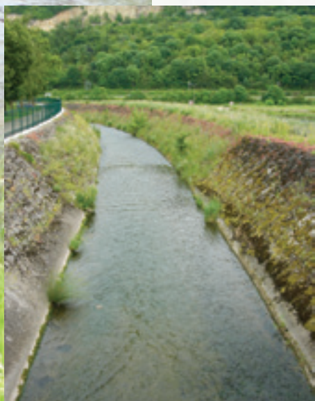
Mauvais état morphologique de la Syre à Mertert : le lit n'est pas seulement réduit en largeur et entaillé en profondeur, mais son fond et ses berges sont en plus consolidé par des ouvrages construits.
