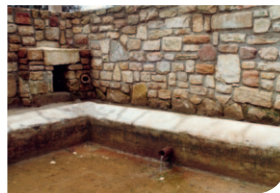
Les deux tuyaux d'amenée des sources en avril 1993 Die beiden Quellenzuleitungen im April 1993
